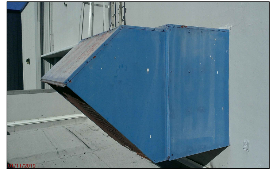
EXISTING SIDEWALL FAN – EXTERIOR
